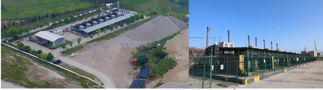
Resim 9: Yenikent Düzenli Katı Atık Depolama Sahası Enerji Üretim Tesisi
